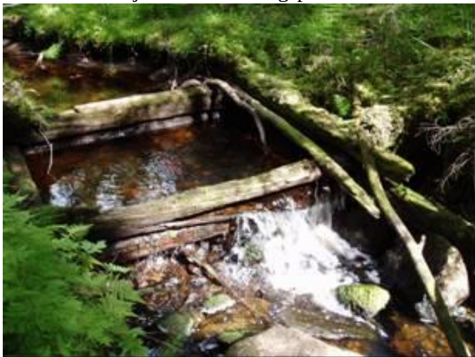
Dammrester i Stadsmyrbäcken innan åtgärd
